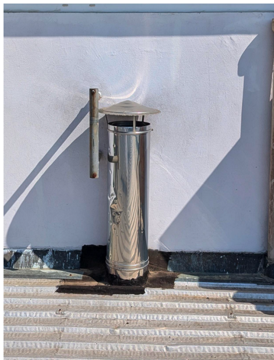
Cappa esistente arrivo in copertura
