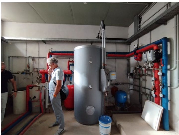
A lato e sopra, immagini del vano tecnico dall'interno
