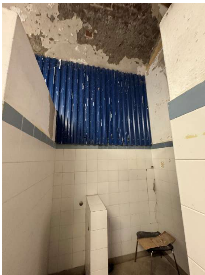
Vista interna: degrado dell'intonaco della volta
