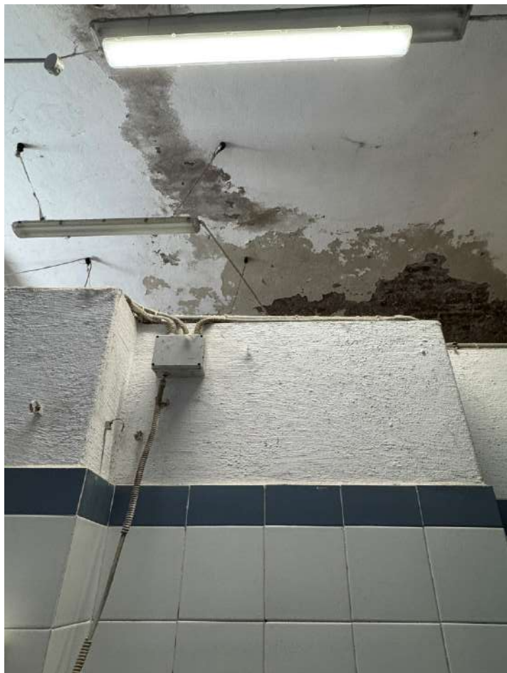
Vista interna: degrado degli intonaci
