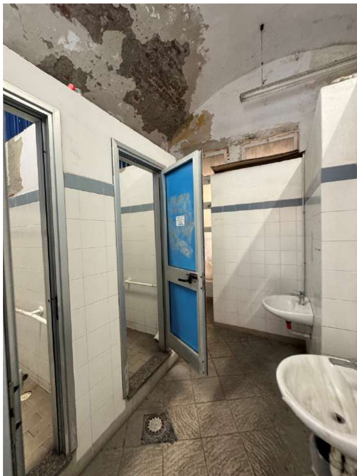
Vista interna: degrado dell'intonaco della volta
