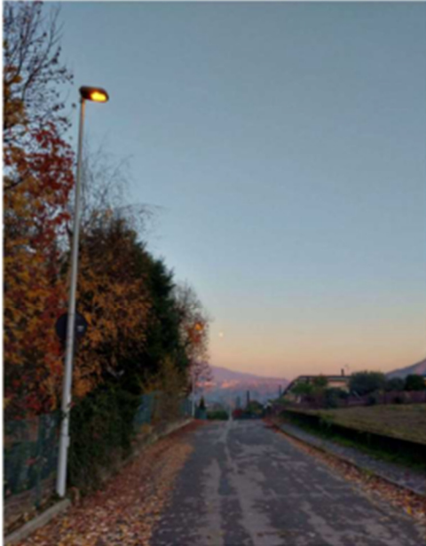
Punto luce comunale con linea interrata
