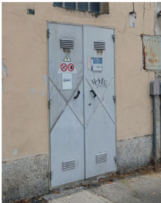
Quadro elettrico privo di contatore ubicato all'interno della cabina Enel Distribuzione
