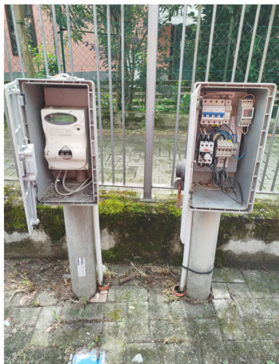
Quadro elettrico su palina con contatore
