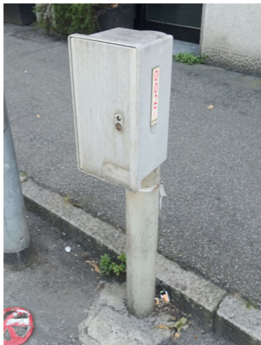
Quadro elettrico su palina privo di contatore
