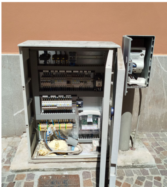
Quadro elettrico a terra con contatore
